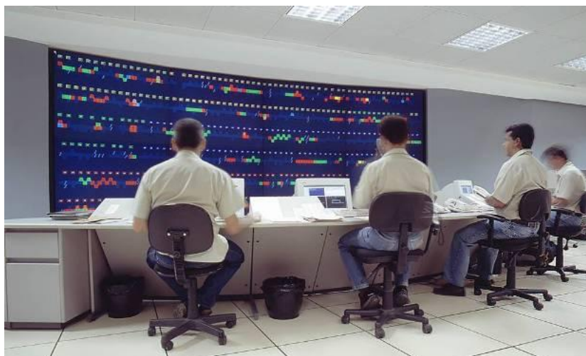
Figura 8: Centro de Controle Operacional
