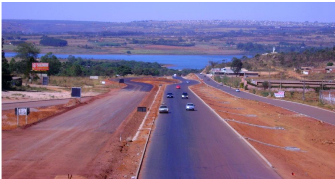
Figura 11: Rodovia BR-070 em duplicação, com destaque para o Lago do Descoberto e o relevo nas proximidades da cidade de Águas Lindas de Goiás, ao fundo. Por: PHsilva
