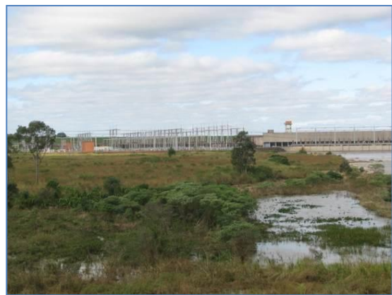
Foto 65: Subestação da UHE de Taquaruçu. 22K – 396007 / 7507367
