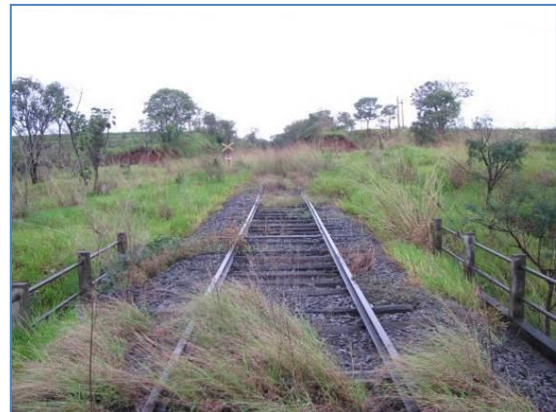
Foto 51: Linha férrea desativada próxima ao trevo de acesso para Ouro Verde. 22K – 435131 / 7625758
