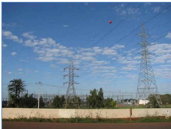
Foto 66: Subestação em Maringá/PR. 22K – 399259 / 7406766
