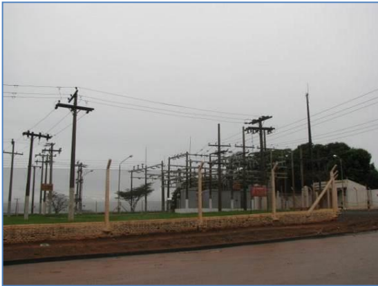
Foto 48: Subestação em Panorama. 22K – 422361 / 7639568
