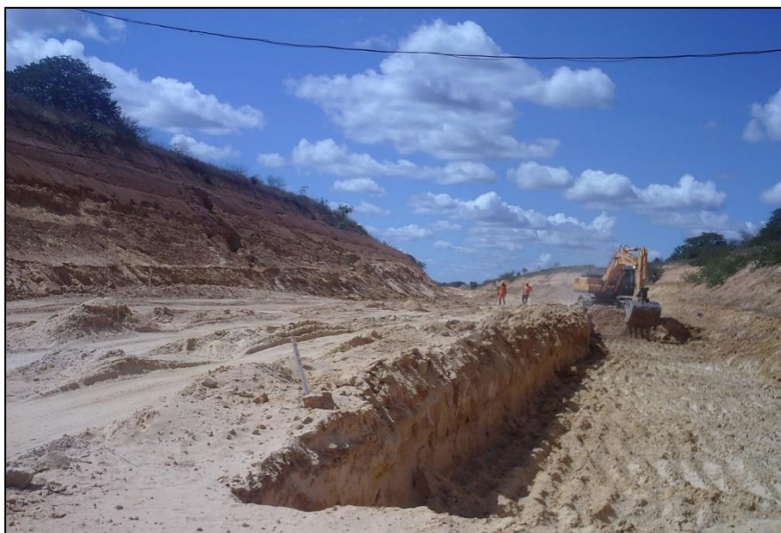
Figura 6. Corte C70, não concluído, apresenta ravinamentos e erosões (km 696+340 ao km 699+850).
