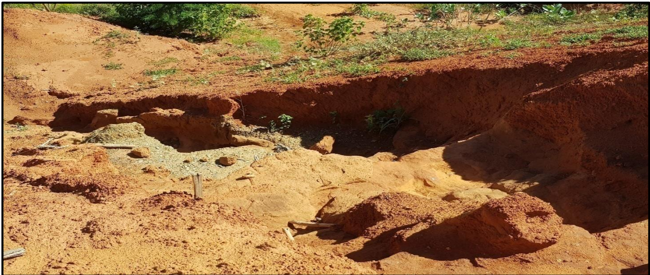
Figura 15 - Talude aterro com processo erosivo km 732+880.
