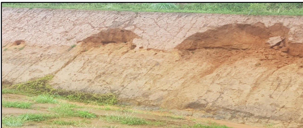
Figura 13– Talude de corte com processo erosivo km 696+800.
