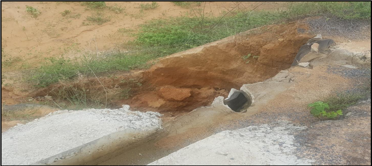
Figura 14 Talude aterro com processo erosivo km 699+860.
