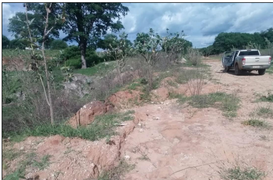
Figura 9. Aterro A 94 com ravinamentos e erosões (km 707+170 ao k 707+210).
