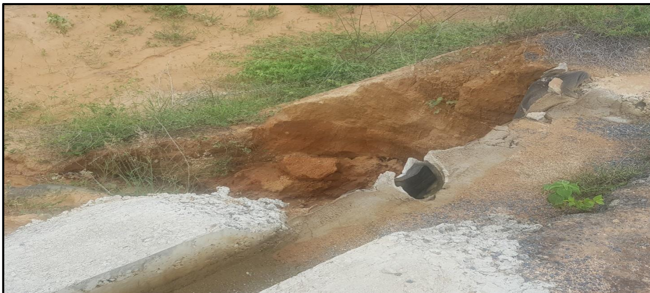
Figura 14 Talude aterro com processo erosivo km 699+860.
