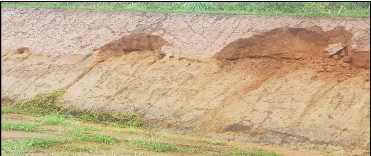
Figura 13- Talude de corte com processo erosivo km 696+800.
