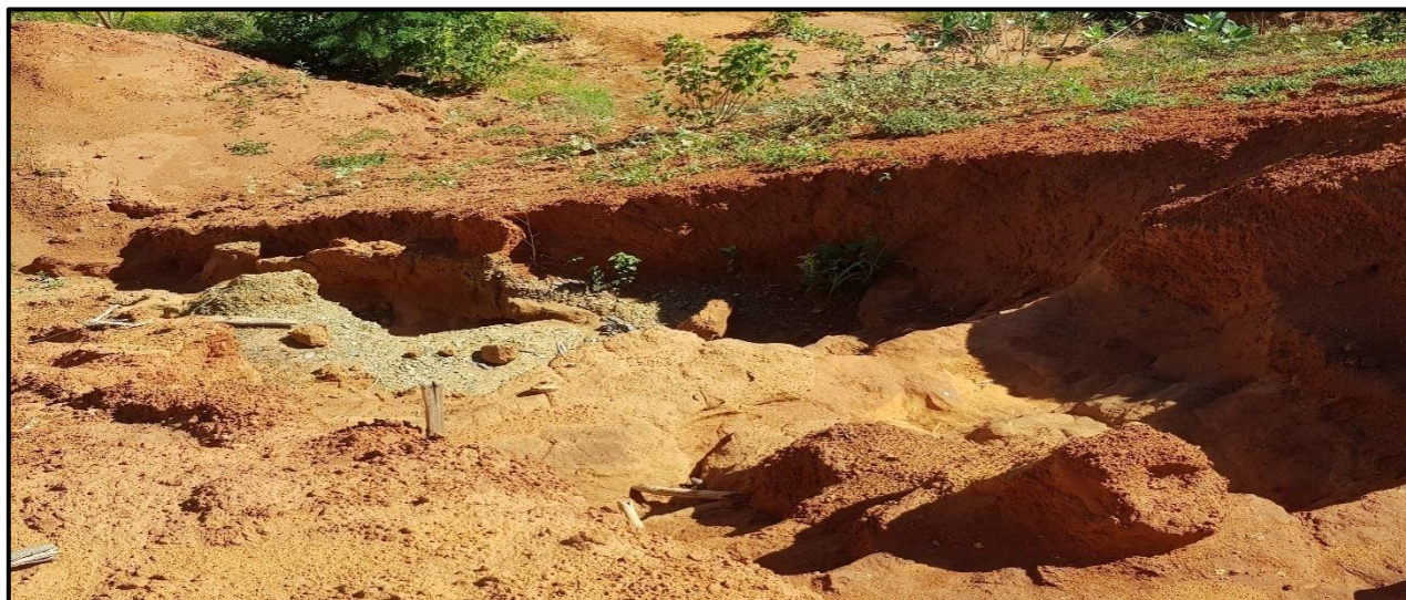
Figura 15 - Talude aterro com processo erosivo km 732+880.
