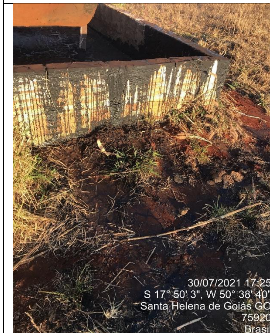
Figura 23. Indícios de derramamento após transbordamento. Fonte: Autor
