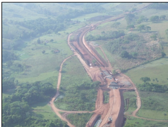
Início da Extensão da FNS em Ouro Verde (GO). Obras da Ferrovia Norte-Sul no local onde será construído o entroncamento ferroviário.
