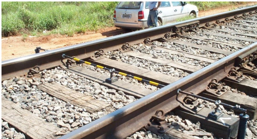
Figura 05 - Fixação da barra detetora na via férrea
