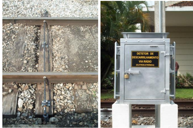
Figura 03 - Sistema de detecção de descarrilamento com barra detetora instalada na via férrea
