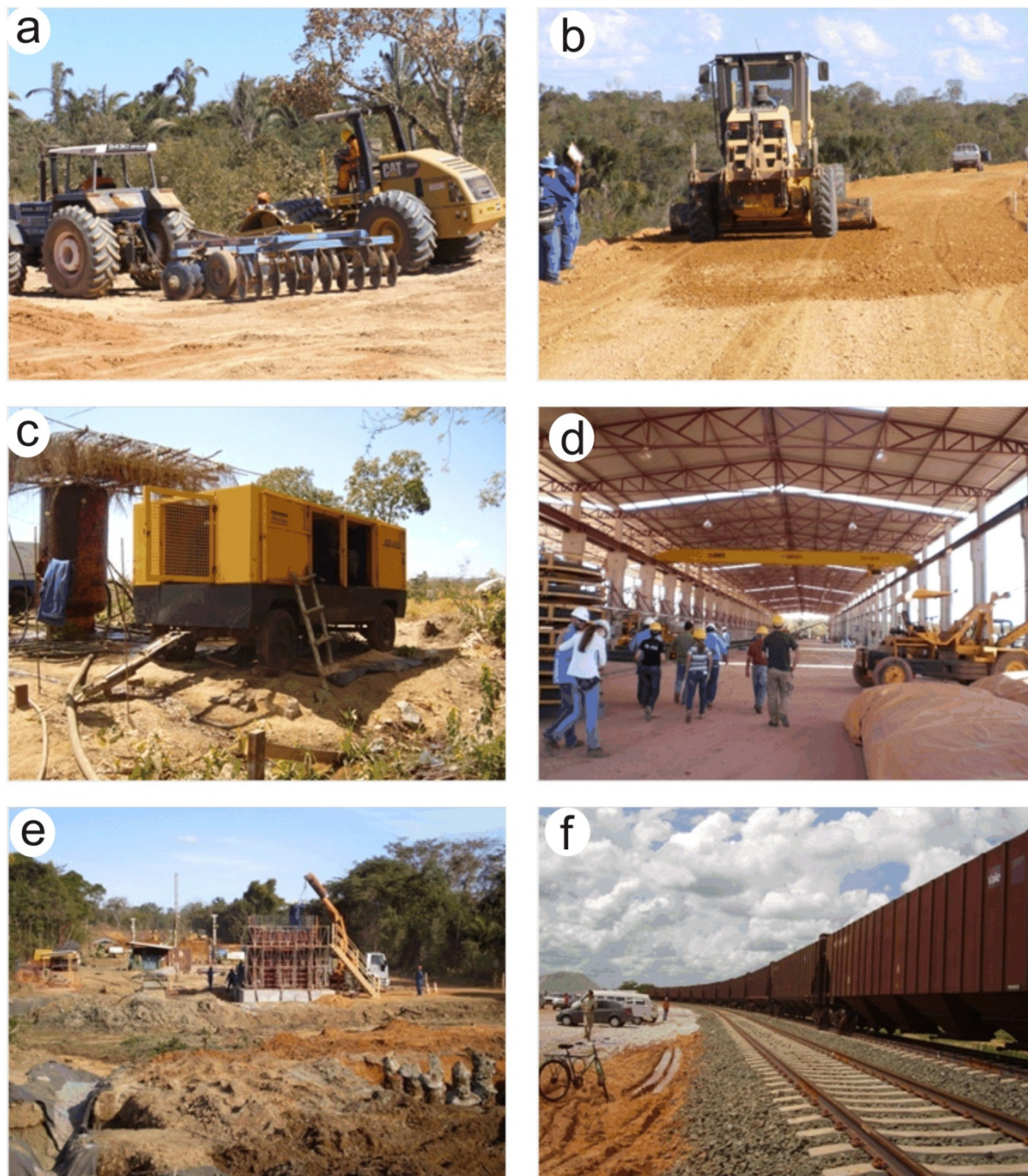
a, b – terraplanagem; c - grupo gerador; d - fábrica de dormentes; e - obras de artes especiais; f - Superestrutura
