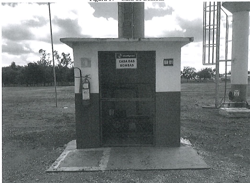
Figura 17 – Casa de Bombas
