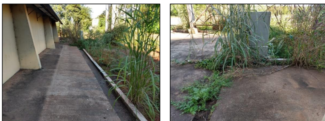
Imagem 07 – Assoreamento das canaletas de drenagem
