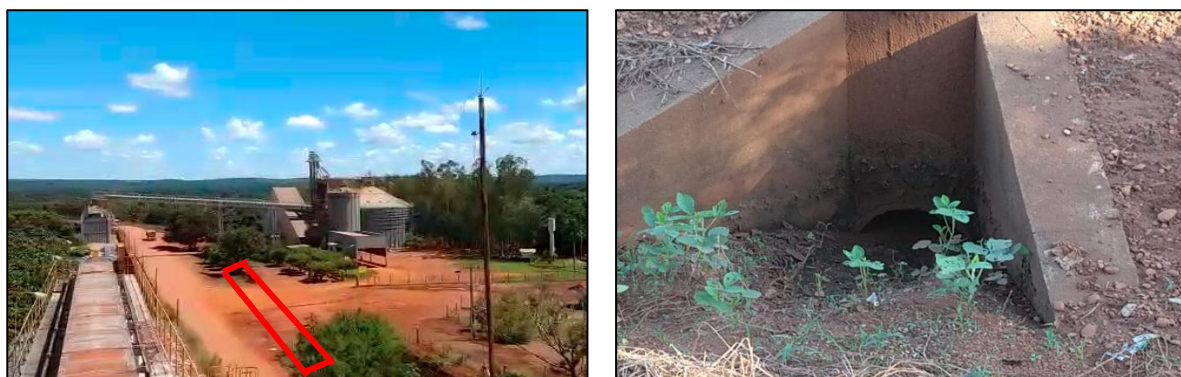
Imagem 10 – Localização e detalhe do bueiro assoreado
