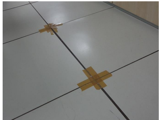
Figura 47: Lajota nivelada com fita adesiva - vista 1.
