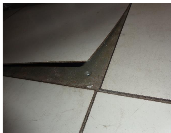
Figura 34: Lajota parcialmente descolada do assoalho.
