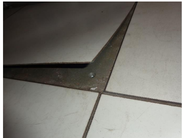
Figura 35: Lajota parcialmente descolada do assoalho.
